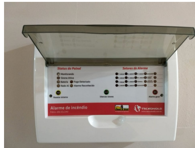
Figura 5 - Central de alarme de uma edificação existente
