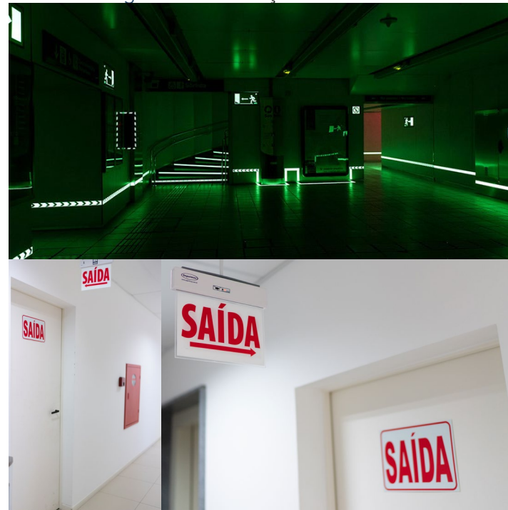
Figura 19 - Sinalização de abandono
