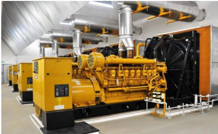
Figura 18 - Conjunto gerador elétrico
