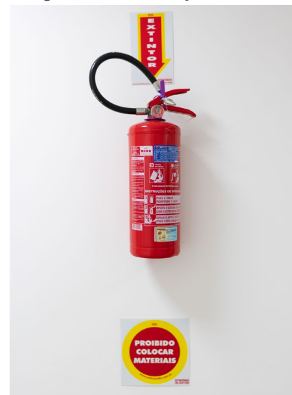
Figura 32 - Sinalização de extintor
