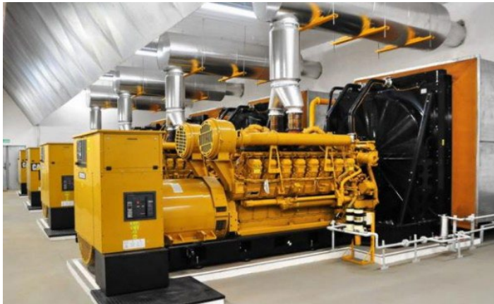
Figura 18 - Conjunto gerador elétrico
