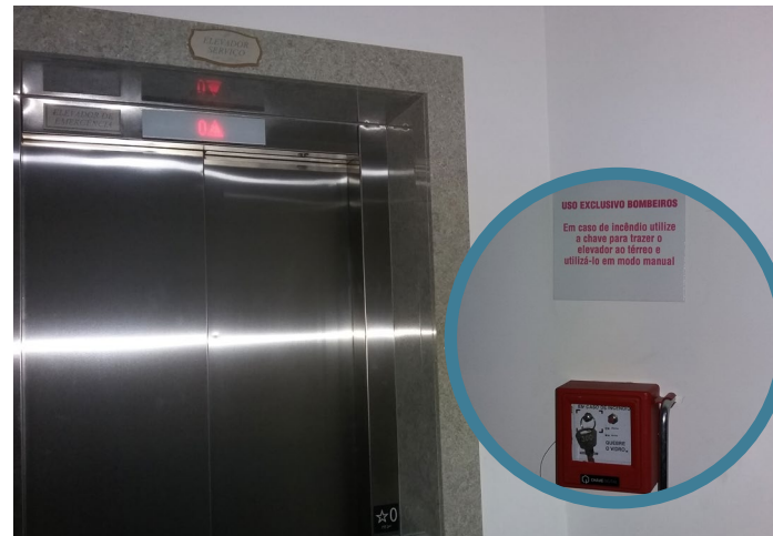
Figura 13 - Elevador de emergência
