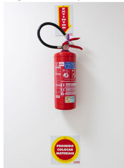
Figura 32 - Sinalização de extintor
