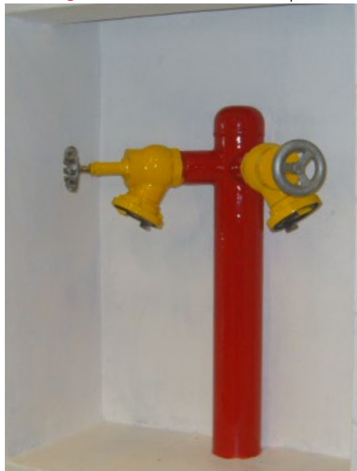
Figura 8 - Hidrante de recalque
