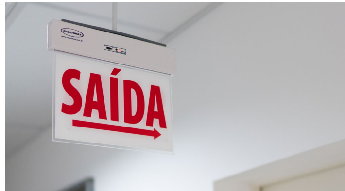
Figura 21 - Placa luminosa de abandono de local
