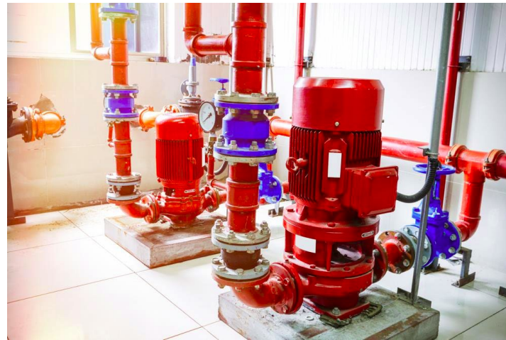
Figura 20 - Bomba hidráulica fixa
