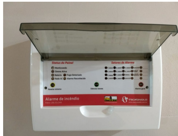
Figura 5 - Central de alarme de uma edificação existente
