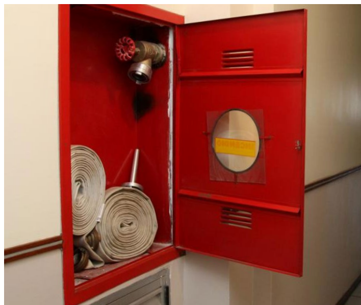
Figura 7 - Hidrante de parede
