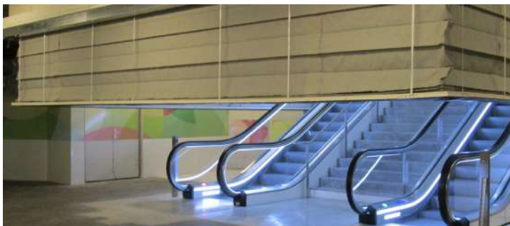
Figura 30 - Cortina automática corta-fogo
