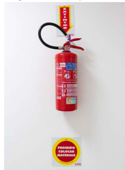
Figura 32 - Sinalização de extintor
