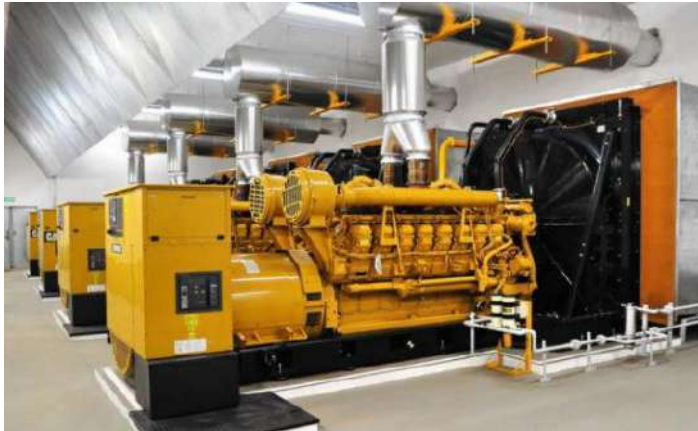
Figura 18 - Conjunto gerador elétrico
