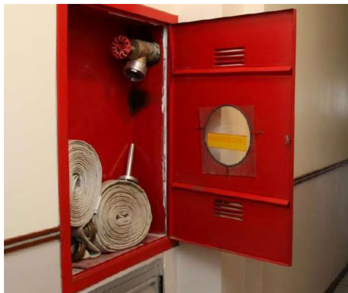
Figura 7 - Hidrante de parede
