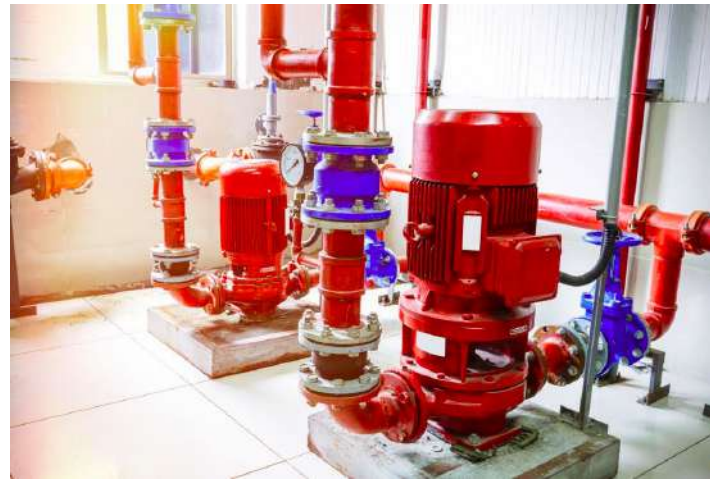
Figura 20 - Bomba hidráulica fixa
