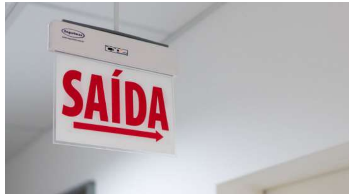
Figura 21 - Placa luminosa de abandono de local
