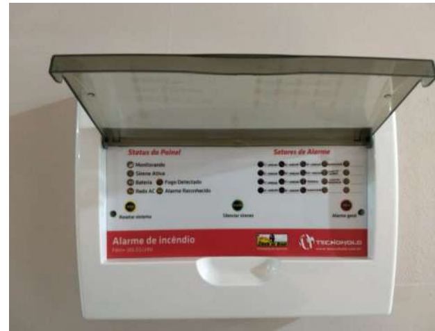
Figura 5 - Central de alarme de uma edificação existente
