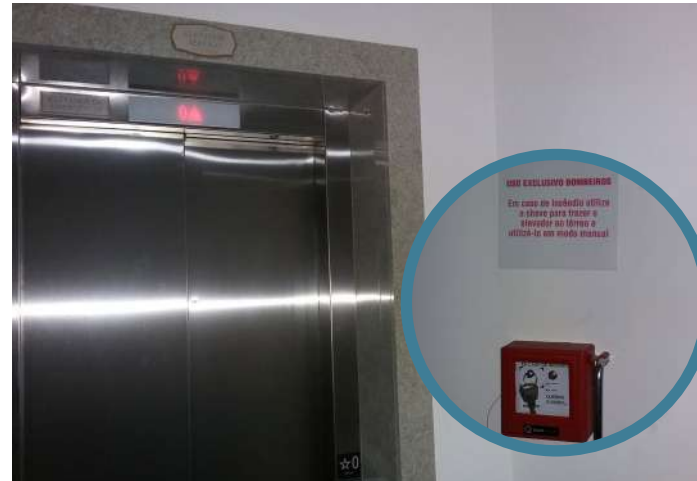
Figura 13 - Elevador de emergência
