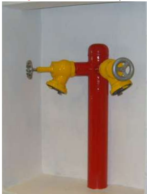
Figura 8 - Hidrante de recalque
