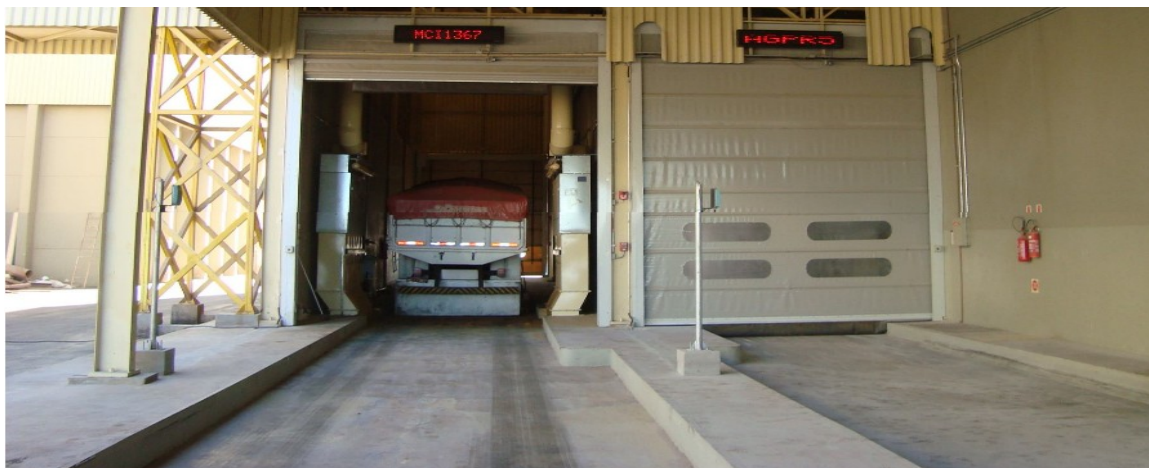
Foto 23 – Enclausuramento das moegas com sistemas de captação de pó
