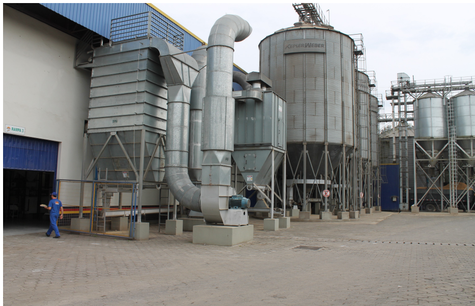
Foto 44 – Filtro manga instalado externamente com ciclone (captação de partículas)
