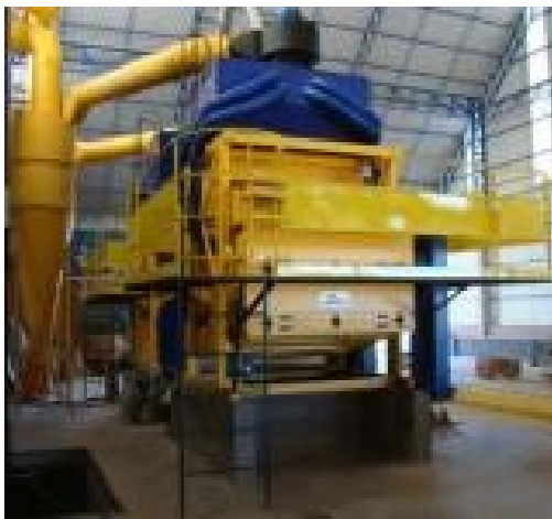
Foto 41 – Máquina de Limpeza com “Ciclone” para captação de partículas.
