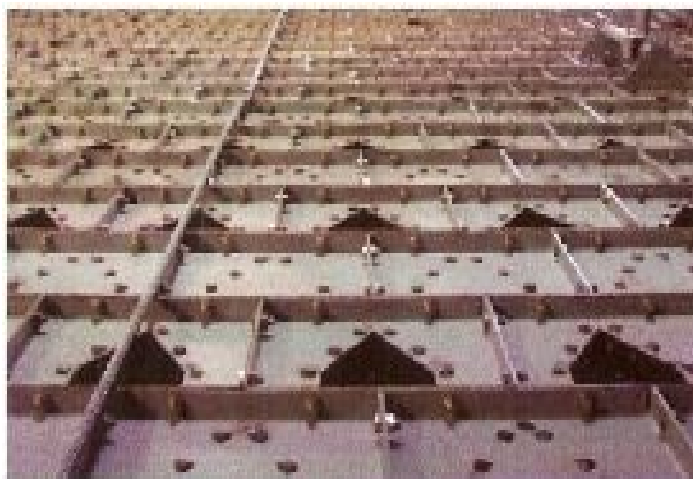
Foto 36 – Dutos intercalados da torre de secagem
