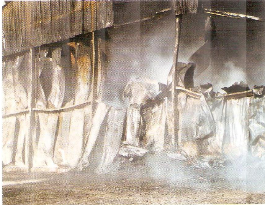
Figura 7- Torções de elementos metálicos
