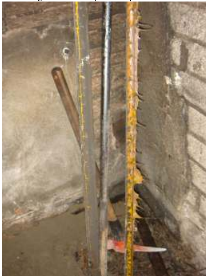
Figura 26 – Tubulação aérea após o incêndio.
