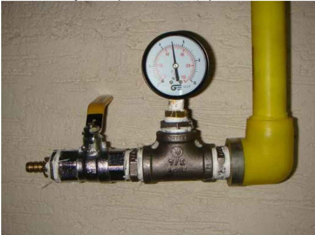
Figura 21 – Conjunto conectado a tubulação pressurizada
